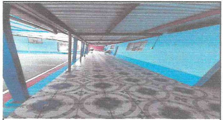
Foto 2: Reparacion de grieta y sustitucion de concreto por piso ceramico anti deslizante
